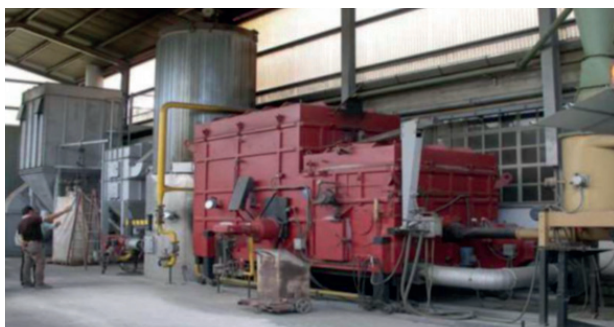
Горелка MD2000, работающая на щепе, в сочетании с котлом на диатермическом масле, снабжающем высокотемпературным теплоносителем формовочные прессы.
